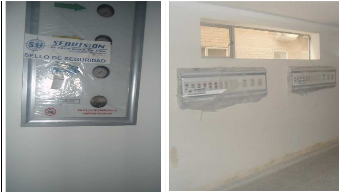
Equipos suministrados pero sin pruebas de energización, mantienen sello de seguridad
